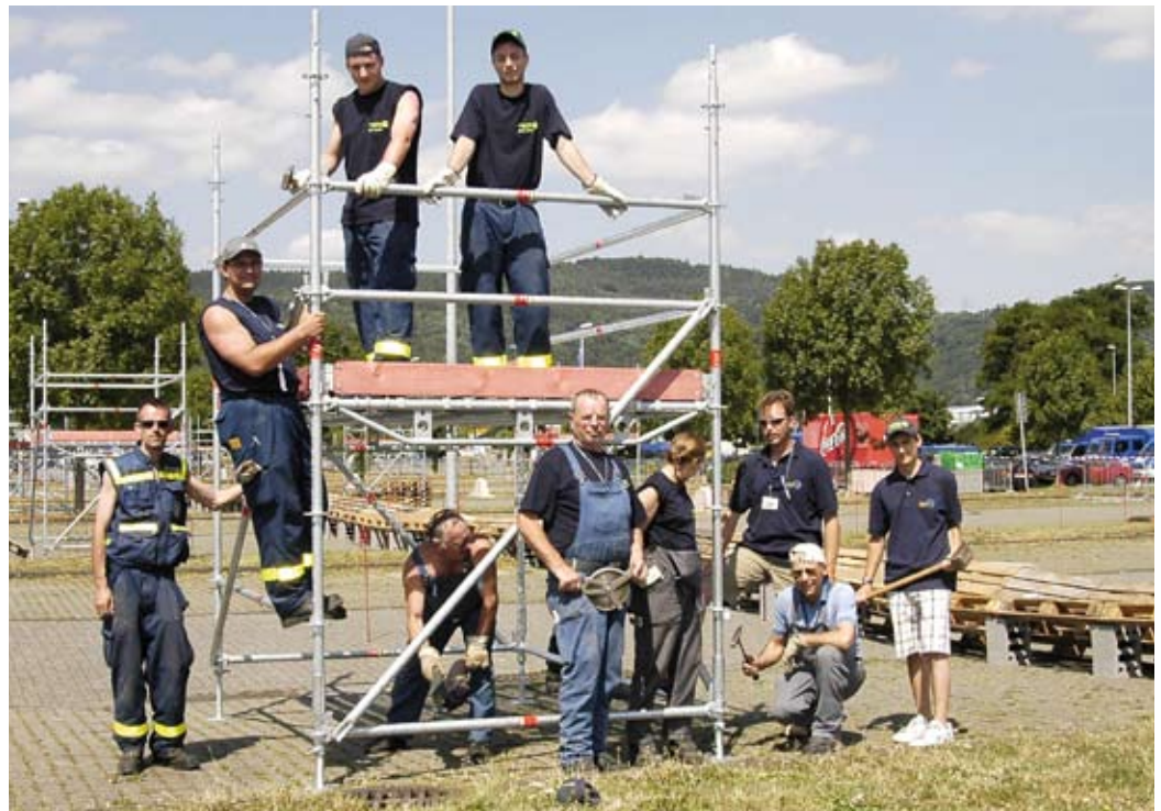
Gemeinschaftsarbeit: Mitglieder des Ortsverbandes St. Wendel bauten gestern einen der Türme für den Wettkampf auf.
