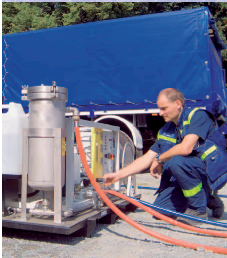
Mit der Umkehrosmoseanlage kann Salzwasser zu Trinkwasser aufbereitet werden.
